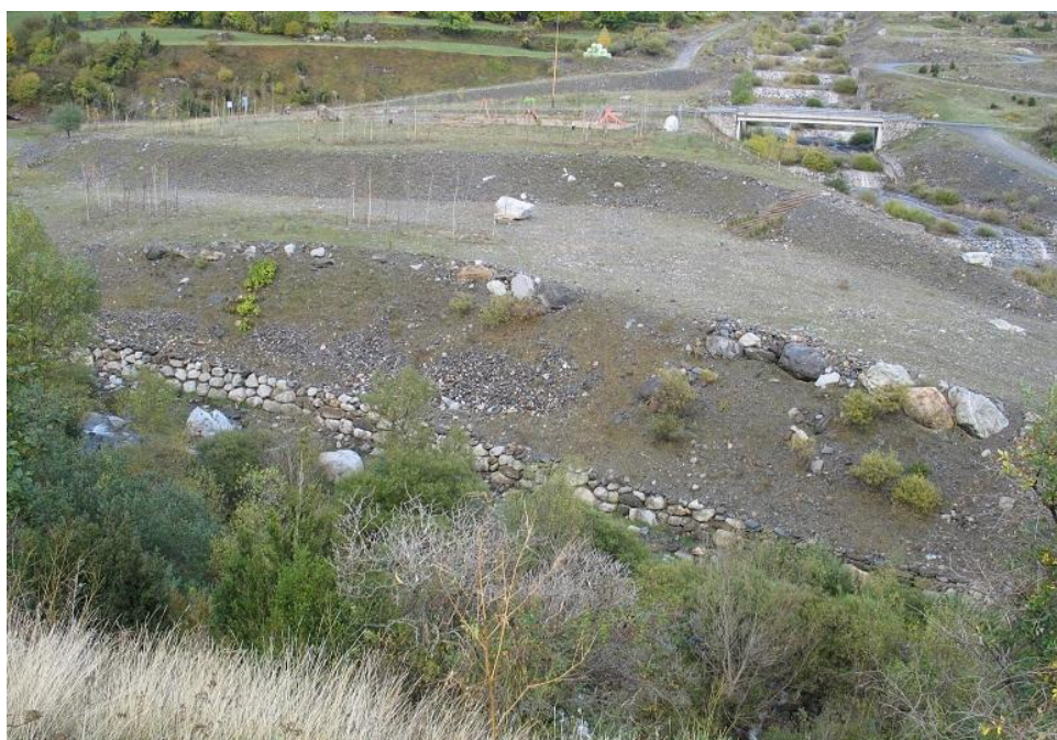
Figura 50-4. Defensa de margen, acumulación de material y alteración en barranco tributario.
