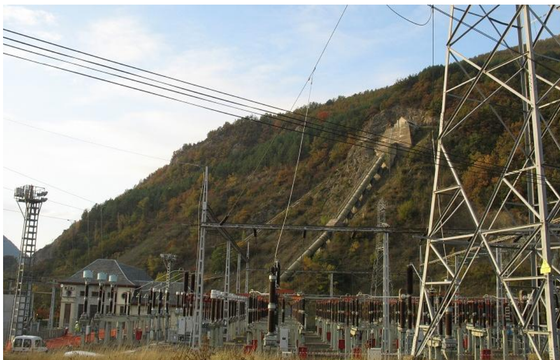
Figura 50-7. Central hidroeléctrica de Pont de Suert.
