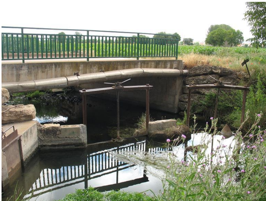
Figura 40-1. Aprovechamiento hidráulico de los caudales del río Jiloca.
